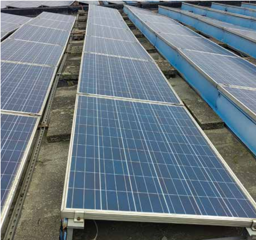
图注：厂区内使用光伏等再生能源
