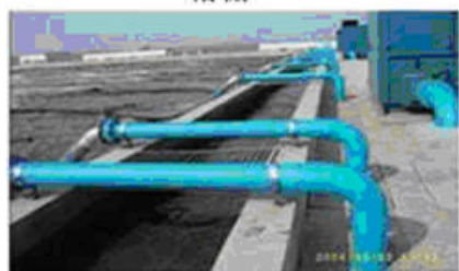
悬挂链生化曝气池
