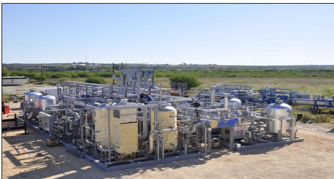
上图为天然气液化撬装设备
