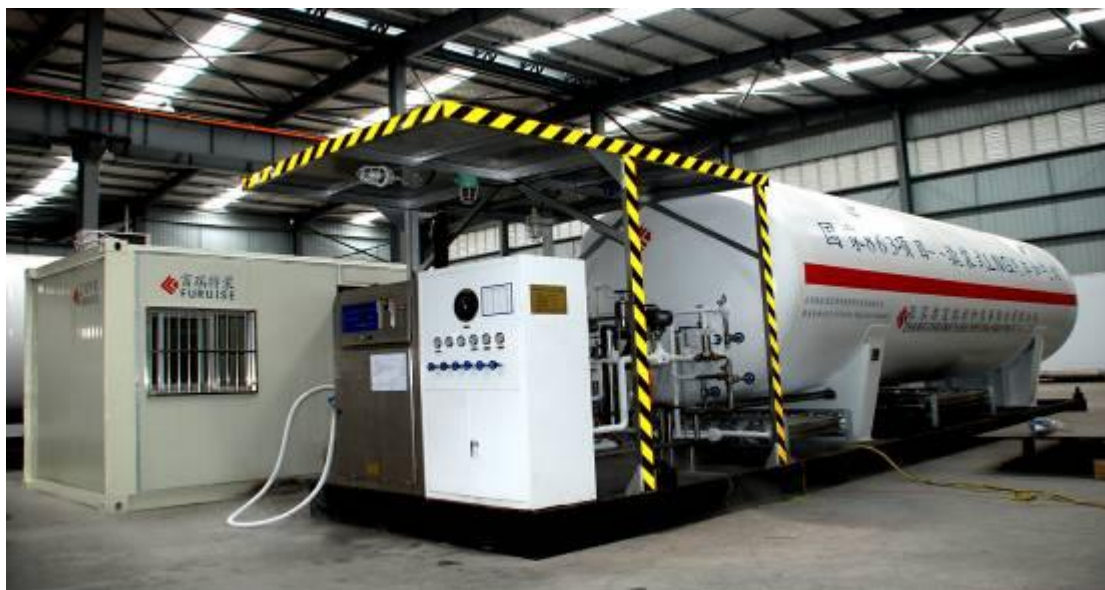
上图为 LNG 汽车撬装加气站
