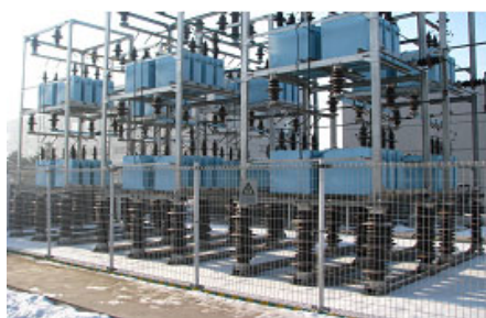
电力电容器 用于 500kV 内蒙树林召变电站
