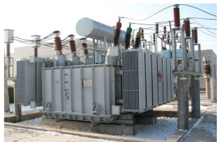
磁控电抗器 在沈阳张官变电所运行
