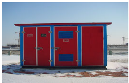
智能箱式变电站 在亮化城市工程中广泛应用
