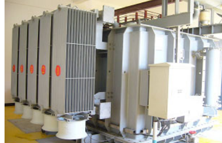
磁控电抗器 在内蒙古神华杭锦能源有限公司运行
