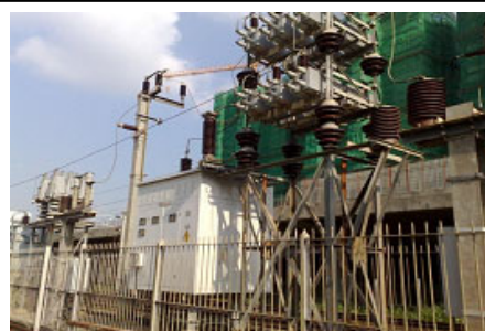
铁芯电抗器 在香港地铁运行现场
