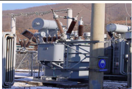
磁控消弧线圈 在丹东太平哨变电站运行
