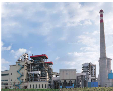
石灰石—石膏法脱硫设备
