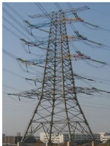
500KV 同塔四回钢管组合转角塔
