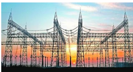
1000KV 晋东南变电构支架
