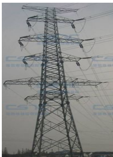
220KV 同塔四回路转角角钢塔
