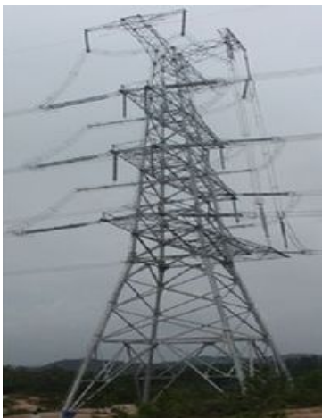
500KV 耐张换位钢管组合塔
