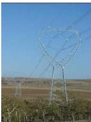
500KV 猫型直线塔
