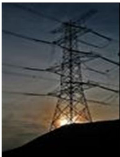
750KV 双回路直线角钢塔
