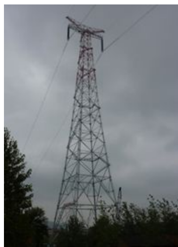
±800KV 向上线大跨越钢管组合塔
