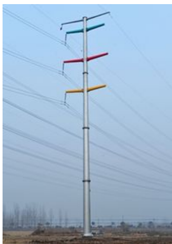
220KV 复合材料绝缘杆塔
