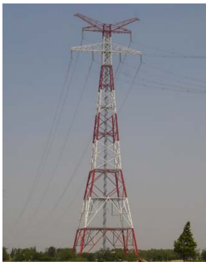
500KV 滁马线安徽马鞍山大跨越钢管塔
