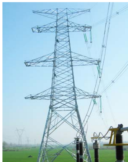
220KV 输电线路铁塔
