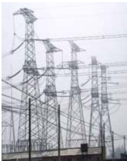
500KV 输电线路铁塔
