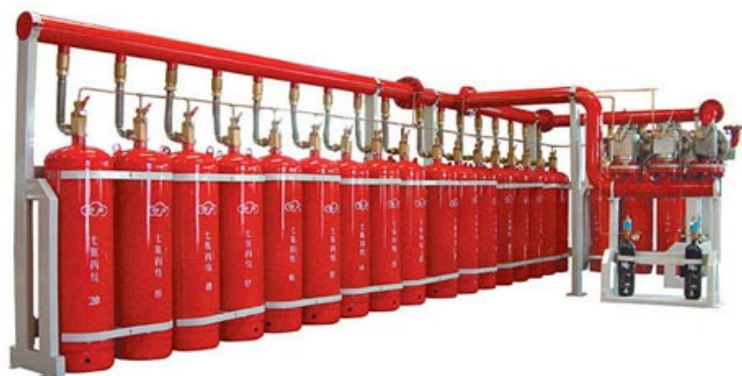
七氟丙烷自动灭火系统
