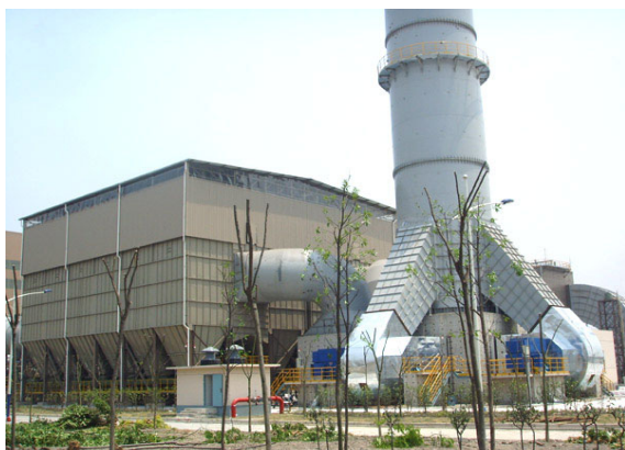
国内最大的 150t 电炉 30384 m 3 袋式除尘器 (冶金行业, 宝钢)
