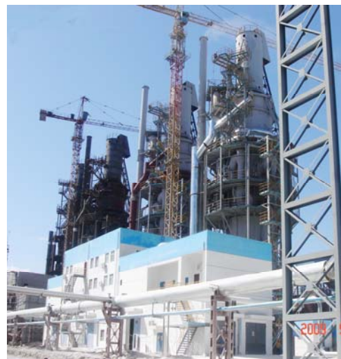
高温炉气净化及利用设备实景
