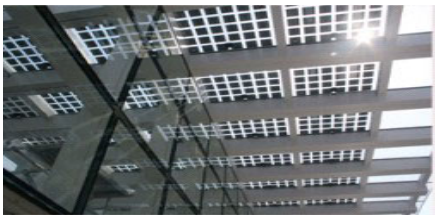
双玻璃光伏屋顶
