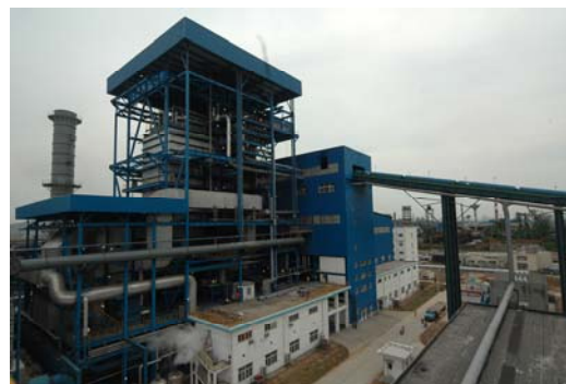
480t/h 高炉煤气混烧锅炉
