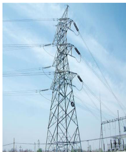
220KV 双回路双分裂转角塔
