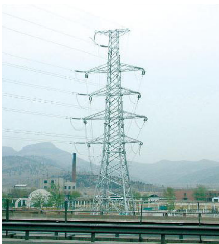
220KV 三回路组合钢管塔
