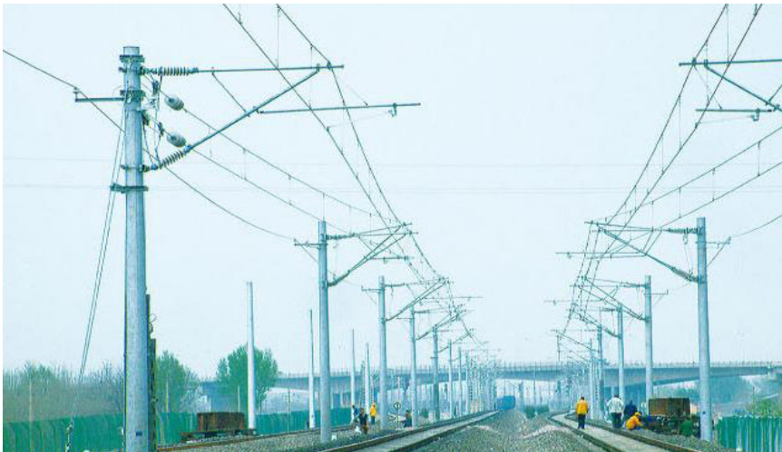
电气化铁路钢管柱
