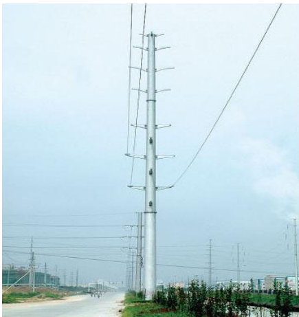
110KV 双回路耐张带双回 T 接塔
