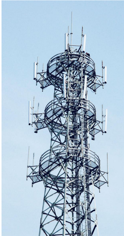
65 米微波通讯塔
