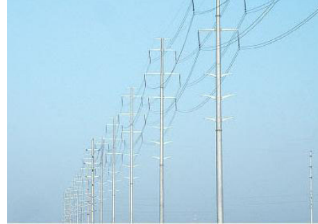
220KV 双回路带 110KV 双回路钢管塔
