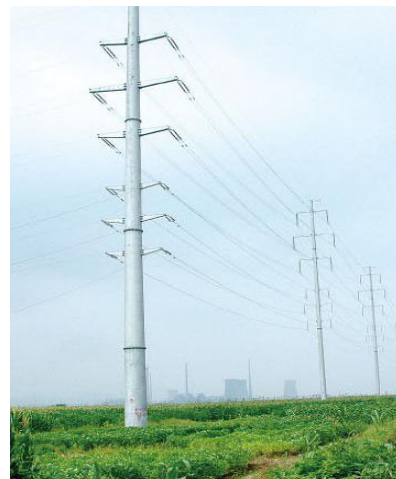
220KV 双回终端带 110KV 双回终端
