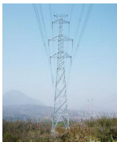
500KV 双回路四分裂直线塔
