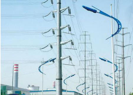
110KV 四回路 90 度转角塔
