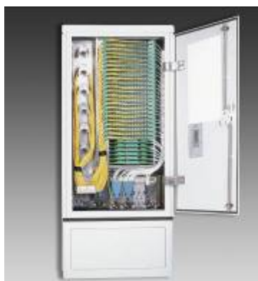
光缆交接箱 XDSL 模块
