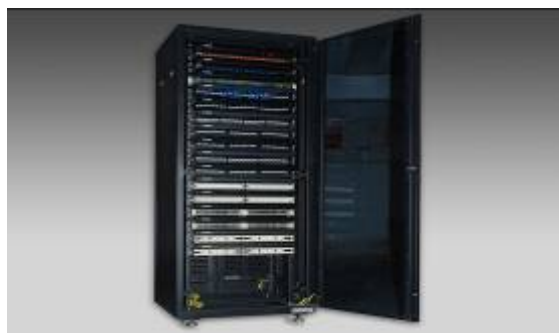
综合布线系统
