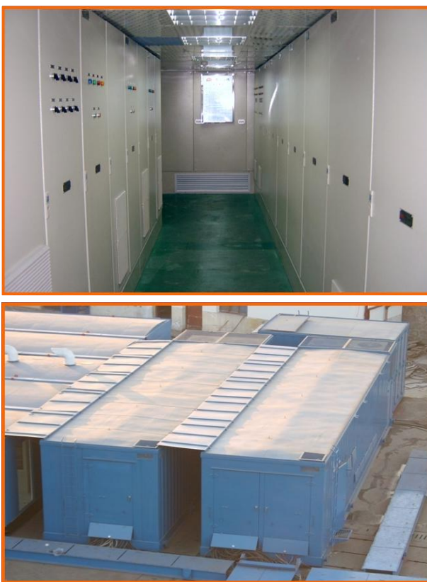
图：9000 米钻机变频控制系统
