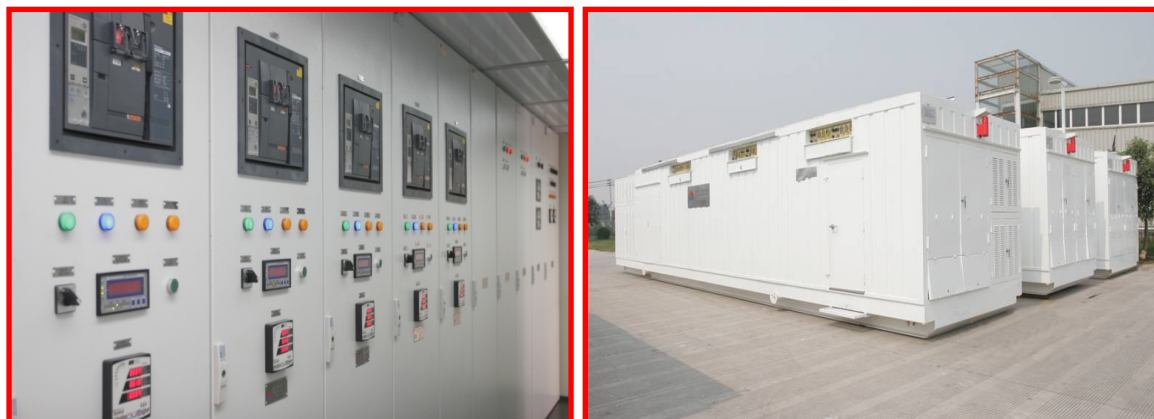
图：12000 米钻机变频控制系统
