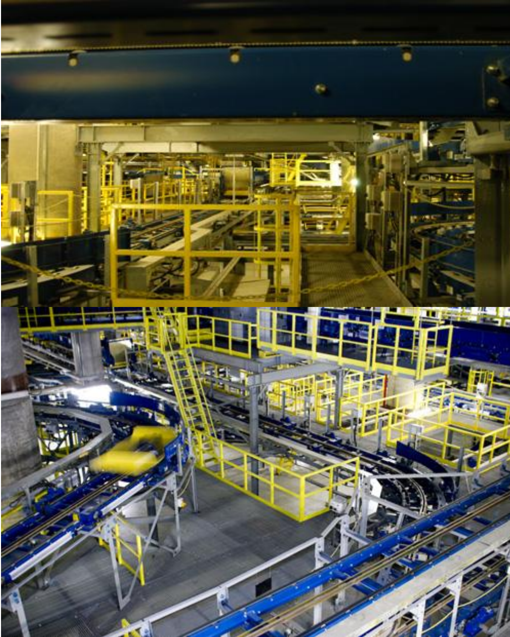
图表 43 北京首都国际机场 T3 航站楼地下的旅客行李处理系统
