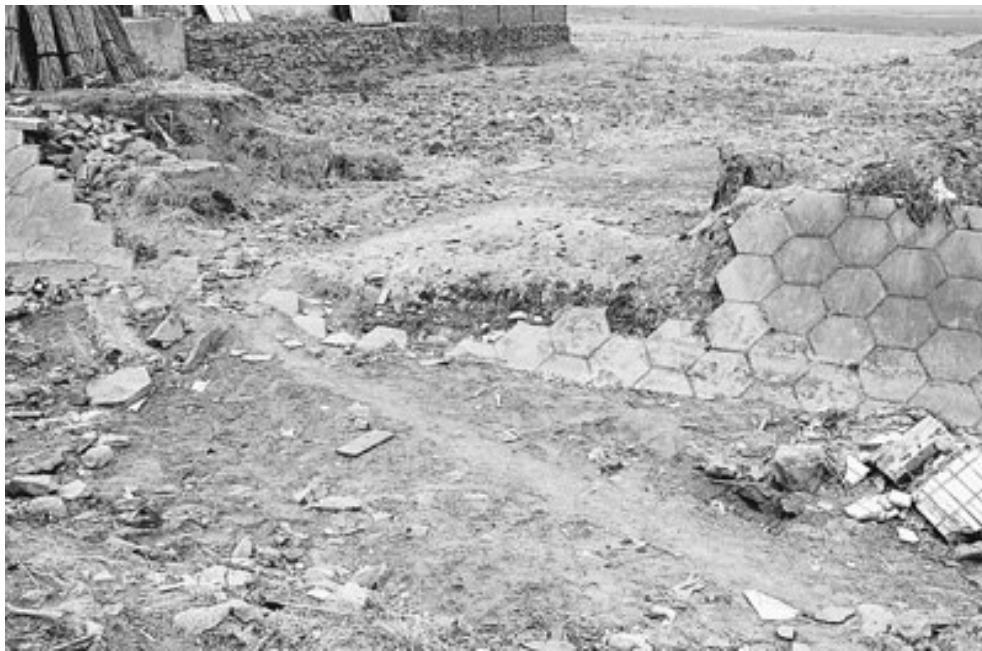
图五：被洪水冲毁的水渠暗示病险水利设施早已无法满足农村水利需求
