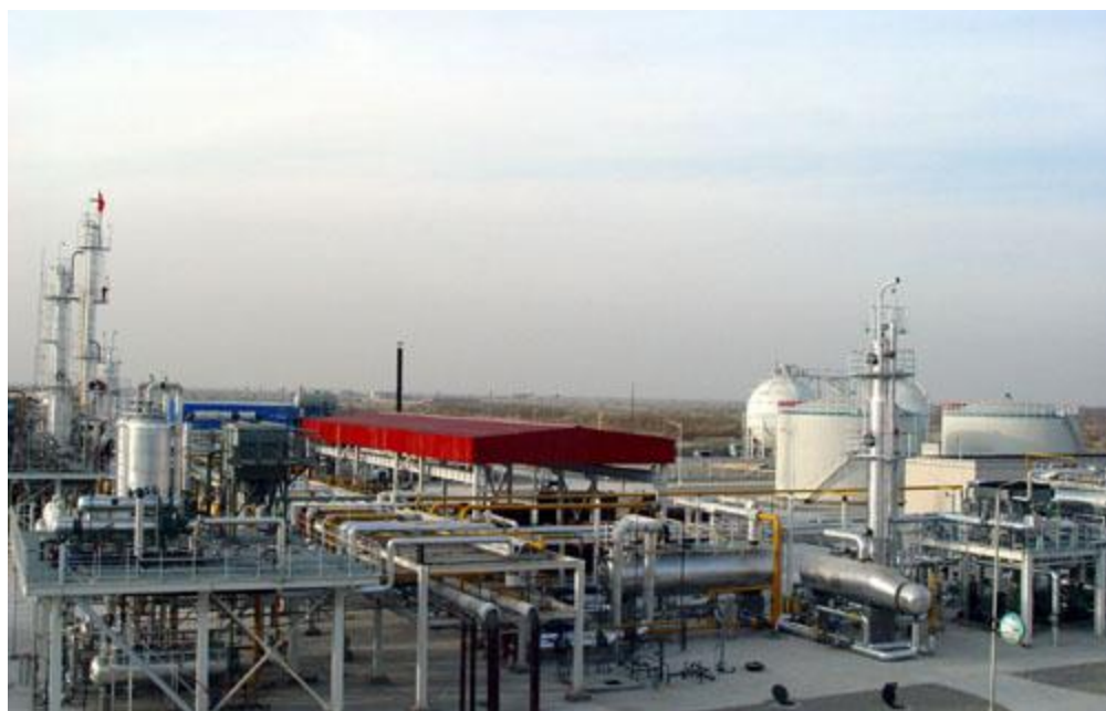
图 1.3 塔河油田一号联合站轻烃回收装置
