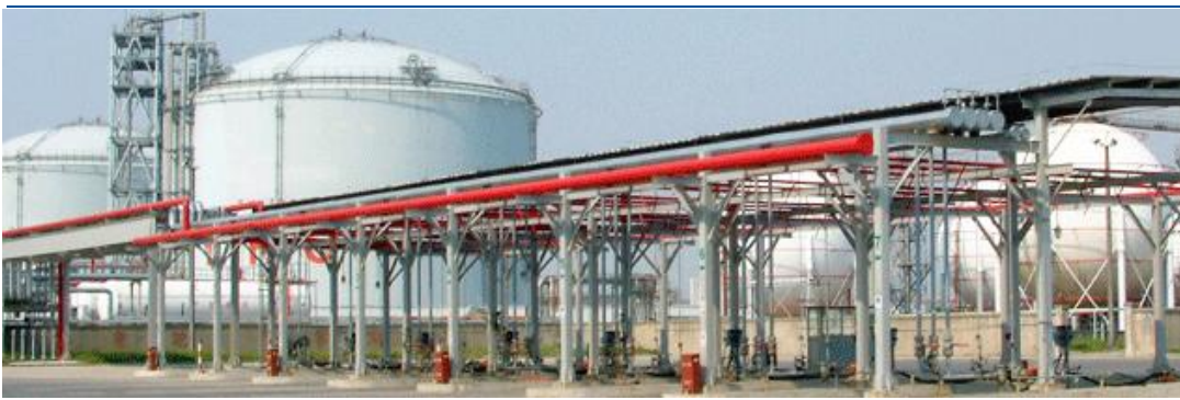
图 6: 公司张家港 20 万立方化工仓储
