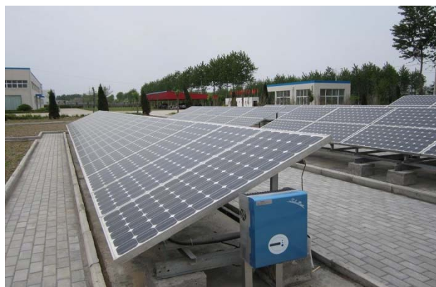
图 22：光伏逆变器及光伏列阵
