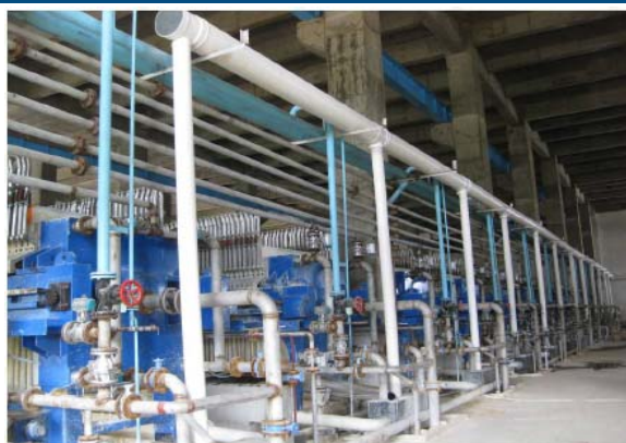
图 25: 北海高岭一期工程展示——压滤系统
