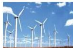
风力发电设备
