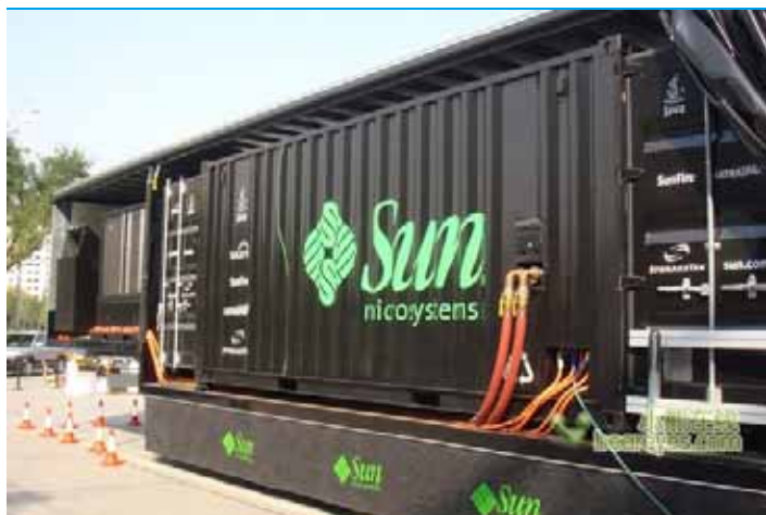
图表2：集装箱可移动式数据中心方便运输
