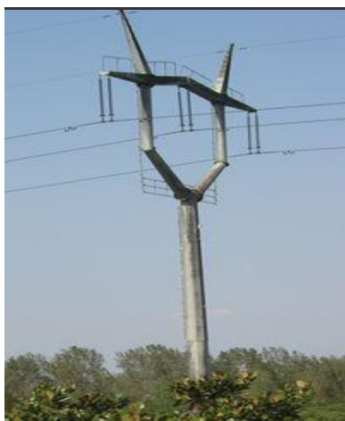
图 4 220KV 杯型单柱钢管塔
