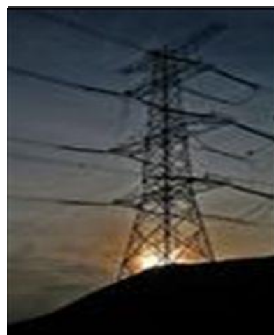
图 3 750KV 双回路直线角钢塔
