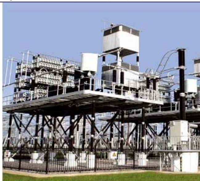
Figure 10 徐州三堡东三 III 线 500 千伏串补工程
