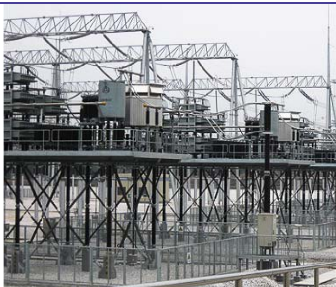
Figure 11 桂林-贤令山双回线串补工程
