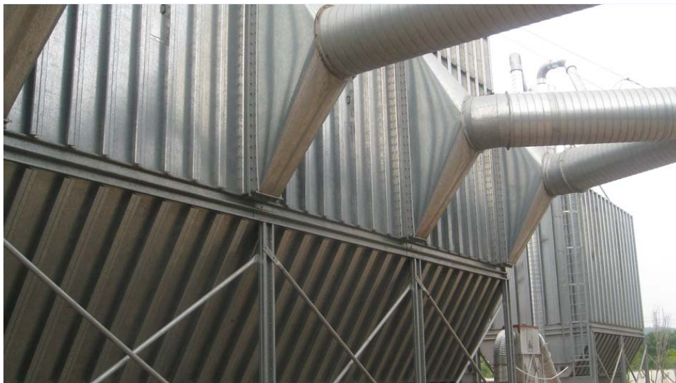
图 21:梅州项目已安装好的大型除尘设备
